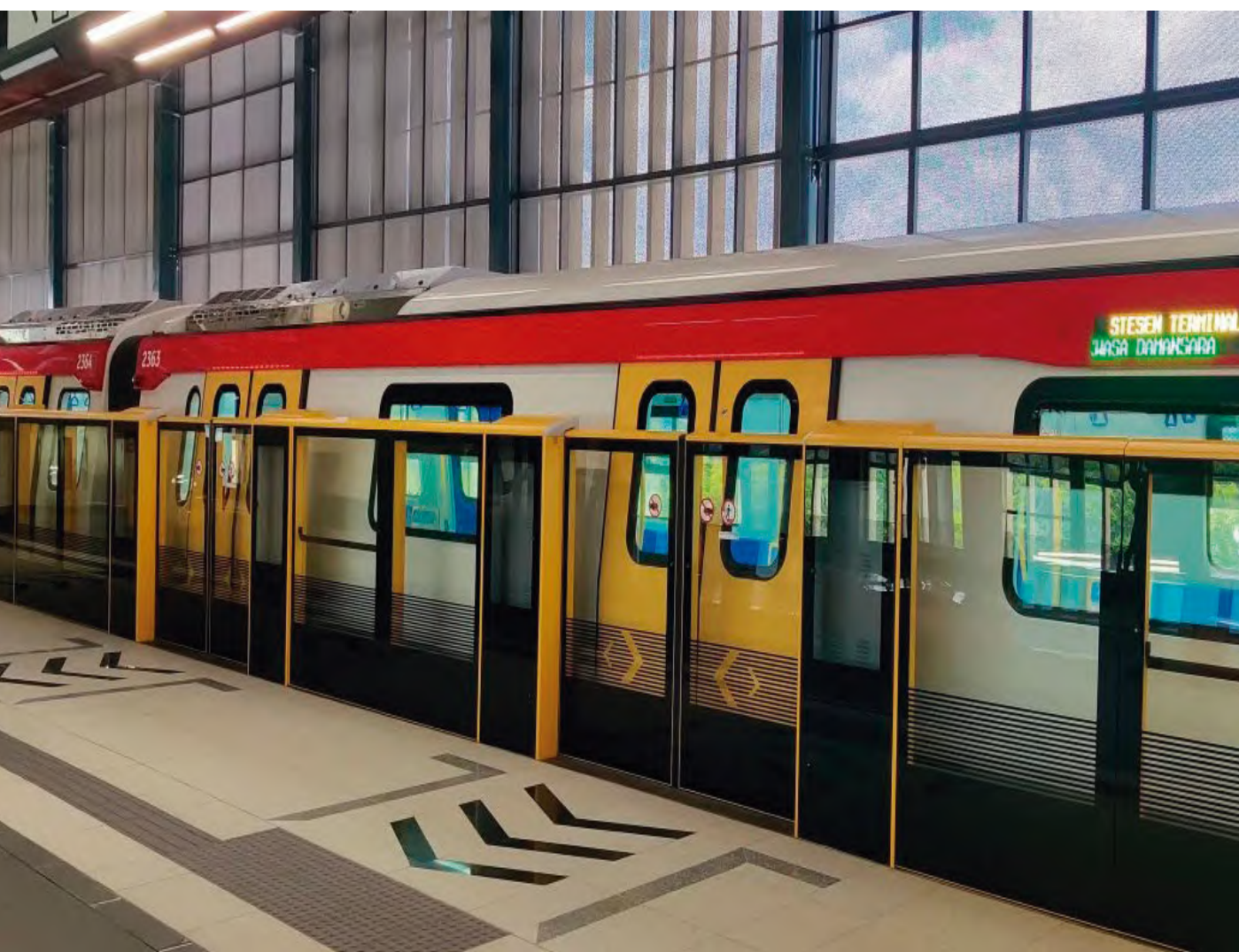
方大智源科技承建轨道交通屏蔽门系统的 吉隆坡 MRT 地铁 2 号线项目
